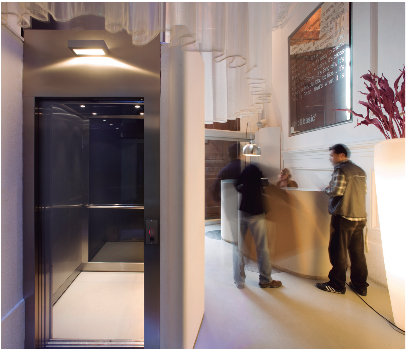
Foto: MP Ascensores
